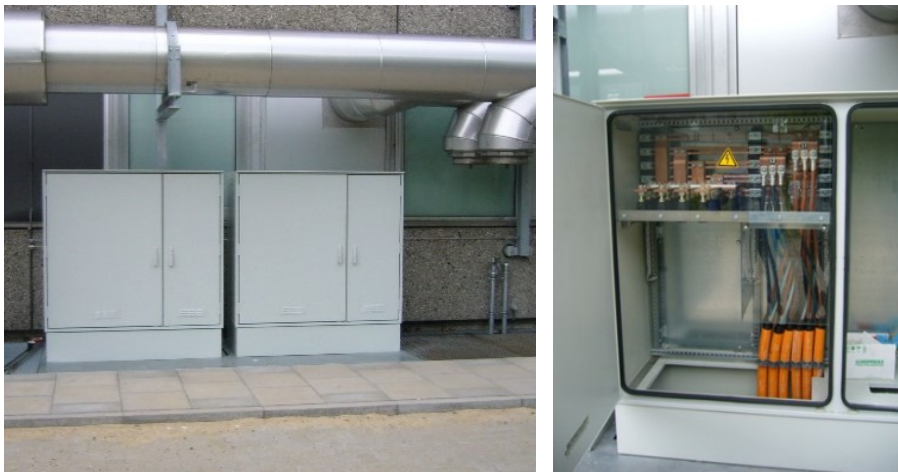
Abbildung 10: Vorbereiteter Aufstellort für eine mobile NEA mit Anschalteschrank und Abgasführung
